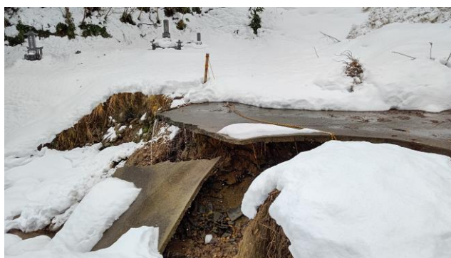
駐車場前崖崩れ箇所
